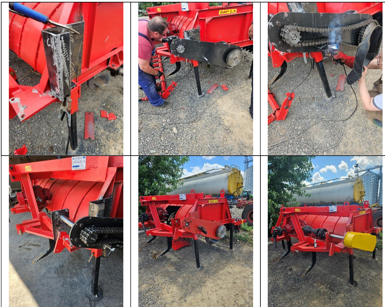
Aspecte din timpul montajului întregului subansamblu re-proiectat "Transmisie cu lant 16B-2, SAP1,5-17.0" pe echipamentului tehnic
