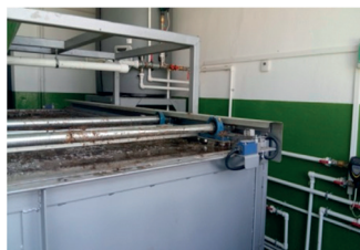
Biodegradarea aerobă a deșeurilor în bazinul cu capacitatea utilă de 4m 3
